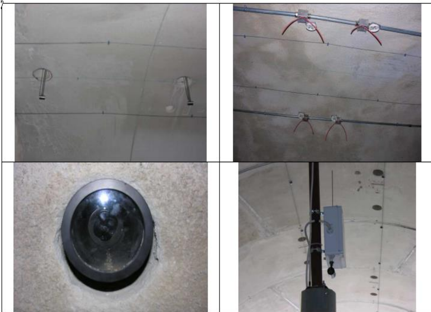
Esempi di sensoristica in galleria
